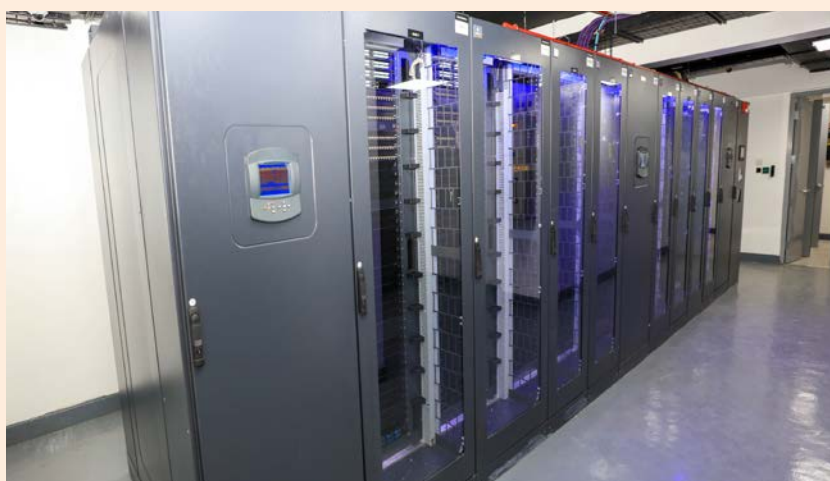
KenGen Data centre.
